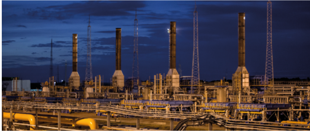
Канчурино-Мусинский комплекс ПХГ
