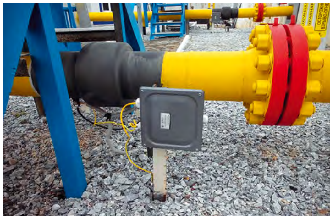
Так выглядит устройство защиты от импульсных перенапряжений, модифицированное Сергеем Жуляковым (Сибайское ЛПУМГ)
